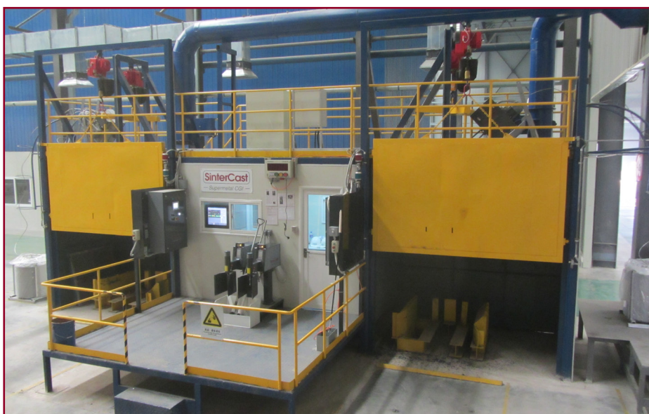
System 3000 Plus basbehandling och korrigeringsstationer hos Zhongding Power foundry, Kina. (Med tillstånd av Zhongding)
